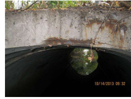
4. spall on west end.JPG
