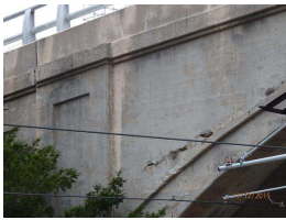
36. s-e corner arch barrel delam-spalling.JPG
