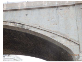
29. n-e corner arch barrel delam-spalling.JPG
