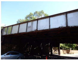
1. impact damage 013.JPG
