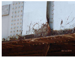
2. impact damage 014.JPG
