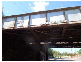
3. impact damage 015.JPG
