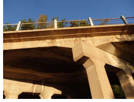
7. E side map cracking.JPG
