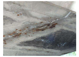
5. Center span delam.JPG
