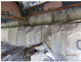
1. abut. North - spalls_1.JPG
