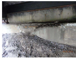
2. abut. North - spalls_2.JPG
