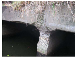
13. spall on south end-2.JPG
