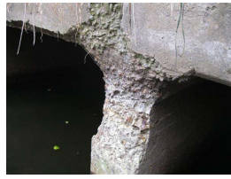
12. spall on south end.JPG
