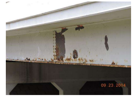
20. flaking paint 035.JPG
