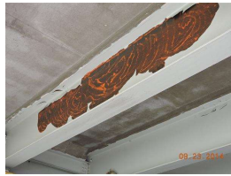
17. flaking paint 019.JPG
