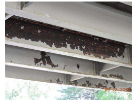
19. flaking paint 021.JPG
