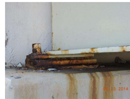
24. SE abut bearing anchor bolt 029.JPG
