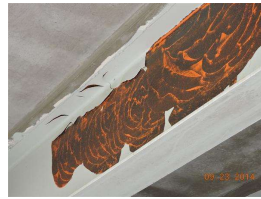
18. flaking paint 020.JPG
