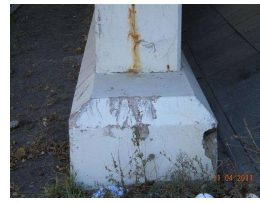
9. column S.side damage_2.jpg
