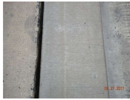
48. Maryland 6599 N. median_cracks_6.jpg
