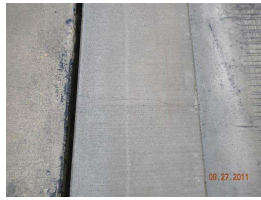
47. Maryland 6599 N. median_cracks_5.jpg
