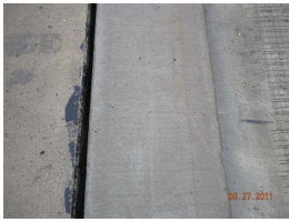
46. Maryland 6599 N. median_cracks_4.jpg
