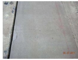
44. Maryland 6599 N. median_cracks_2.jpg
