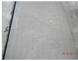
43. Maryland 6599 N. median_cracks_1.jpg
