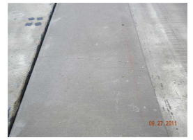
45. Maryland 6599 N. median_cracks_3.jpg
