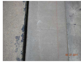
49. Maryland 6599 N. median_cracks_7.jpg
