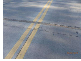
9. approach spall - N.side.JPG
