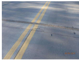
2. approach spall - N.side.JPG
