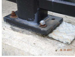
7. 6-23-2011_Rail post anchors_4-1.JPG
