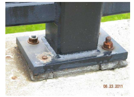
5. 6-23-2011_Rail post anchors_2-1.JPG
