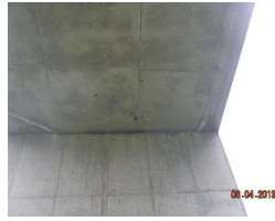
42. underdeck distress E.side_9.JPG
