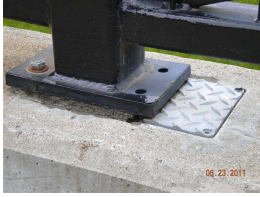
6. 6-23-2011_Rail post anchors_3-1.JPG
