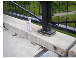
4. 6-23-2011_Rail post anchors_1-1.JPG
