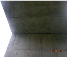
41. underdeck distress E.side_8.JPG
