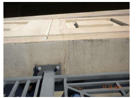
40. outlet wall crack_2.jpg
