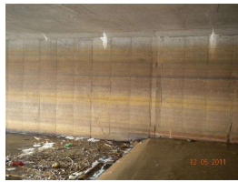
38. outlet drop W.side_2.jpg
