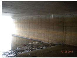
37. outlet drop W.side_1.jpg
