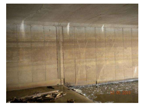
35. outlet drop E.side_1.jpg
