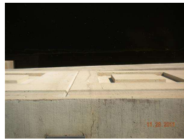
39. outlet wall crack_1.jpg
