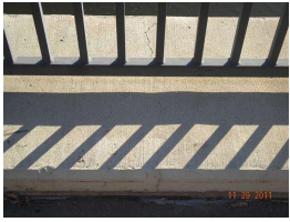
41. outlet wall crack_3.jpg
