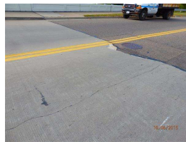
27. 026 N approach unsealed cracks..JPG
