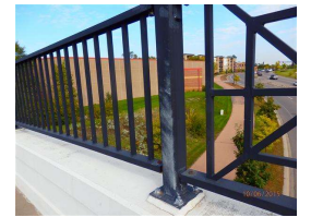
25. 024 SE corner paint failure on railing..JPG
