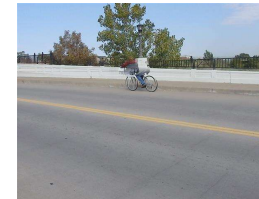
29. 029 Deck cracking smart flag..JPG
