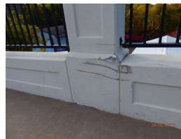
28. 027 SW parapet collision damage..JPG
