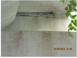
1. Crack in SE Parapet.JPG
