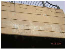
36. Headwall S.end cracks_4.jpg
