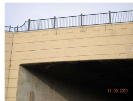
34. Headwall S.end cracks_2.jpg
