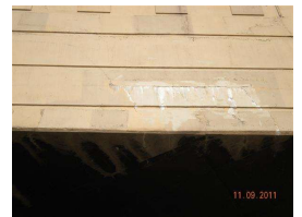
35. Headwall S.end cracks_3.jpg
