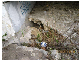
2. erosion on SE corner.JPG
