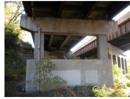
29. pier cap spall_1.jpg
