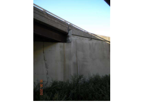
20. abut W. cracks_1.jpg
