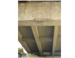
34. pier cap spall_3.jpg
