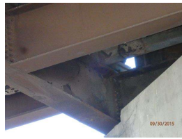
37. steel pier cap moderate rust.JPG
