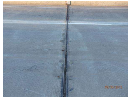
27. section 3-4 strip seal.JPG
