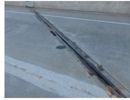
24. section #6 strip seal (2).JPG
