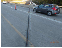
21. section #6 strip seal.JPG
