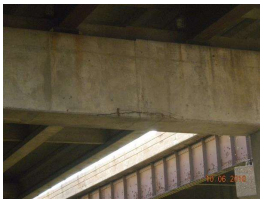
31. pier cap spall_2.jpg
