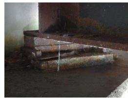
19. south abut. flaking rust.JPG
