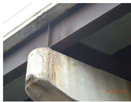
23. piercap N.end spall_3.jpg
