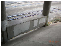
18. pier columns S.end cracks_1.jpg
