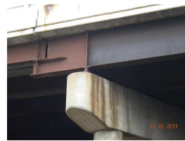
24. piercap S.end staining.jpg
