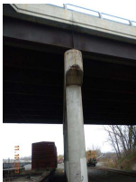
21. piercap N.end spall_1.jpg
