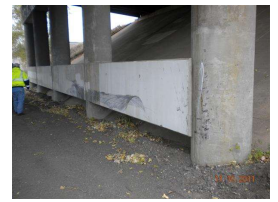
20. pier columns S.end impact damage.jpg
