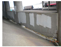
19. pier columns S.end cracks_2.jpg
