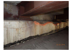
20. 033 SE abut, severe spalling..JPG
