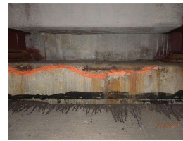
4. abut seat spall 029.JPG
