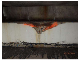
2. abut seat spall 028.JPG
