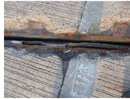
8. extrusion deterioration 036.JPG
