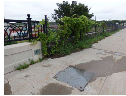
28. SE corner dirt and weed encroachment.JPG
