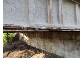
10. abut SW fascia b mapcracking.JPG
