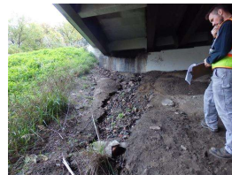
29. Slope washout at SE end.JPG
