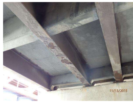
3. beam ends pier 4 - rusty.JPG
