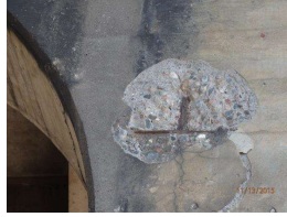
8. column spall pier 2 south face.JPG
