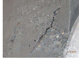
9. column spall pier 4 south end.JPG
