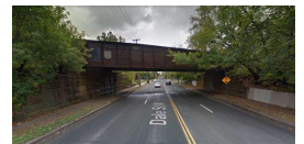
25. SB elevation warning signage.PNG
