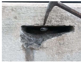
2. 018-sidewalk edge spall Unit 8a-d,ss.jpg
