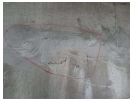
3. 019-spandrel beam spall, Unit 8b btw t-s, ss.jpg
