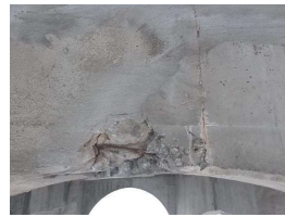
4. 020-spandrel beam spall Unit 4 btw a-b, ns.jpg
